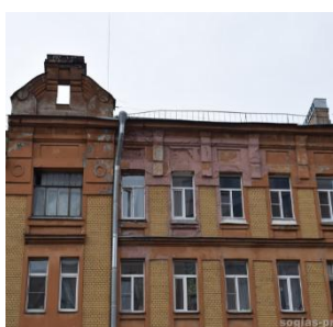
Рис.8 Некачественный ремонт исторических зданий
